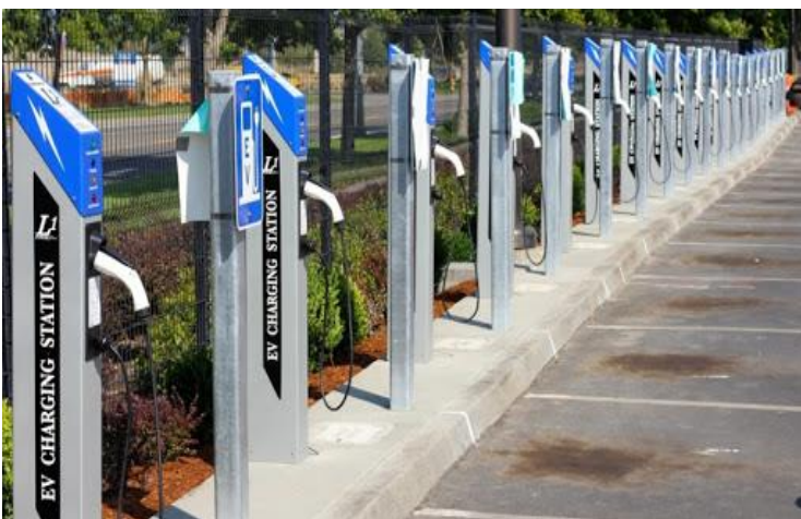
Εικόνα 20: Σταθμός φόρτισης ηλεκτρικών οχημάτων.
